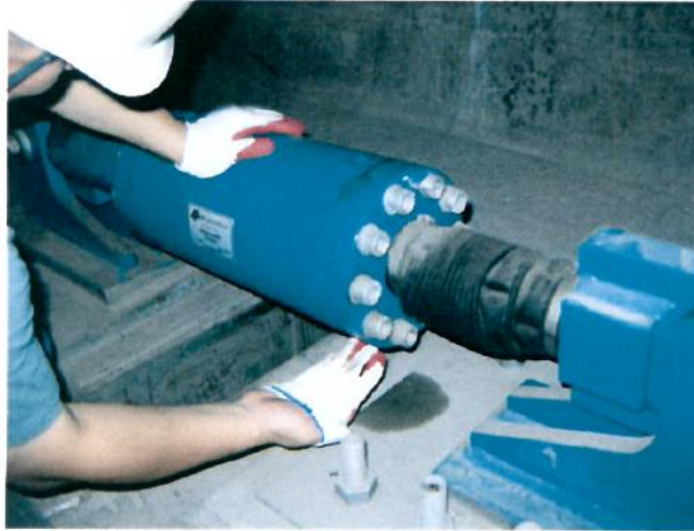
Figura 2. Fuga de fluido en disipador sísmico viscoso en zona de pistón
